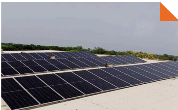
Seva Industries 60.18 kWp
