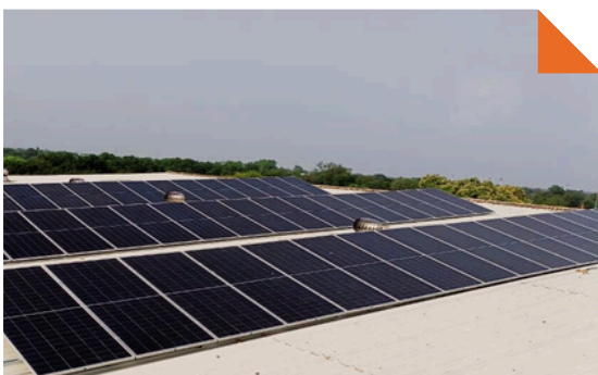
Seva Industries (60.18 kWp)
