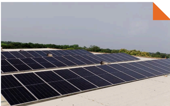
Seva Industries (60.18 kWp)
